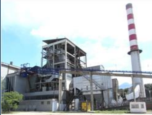
Yakıcının Isıl kapasite 3 MWth
