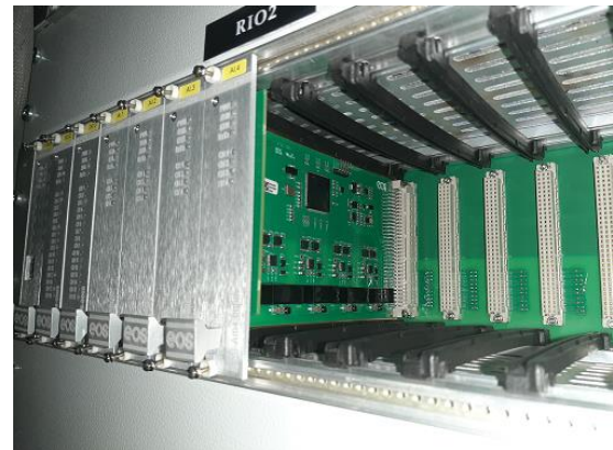
Şekil 26. Gökçekaya HES Sahası Uzak Giriş/Çıkış Birimi
