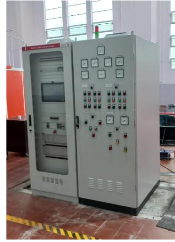
Şekil 24. Çatalan HES Sahası EOS Donanım Kabini
